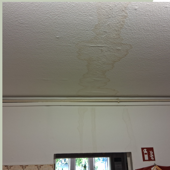
Wasserschaden in der Küche
