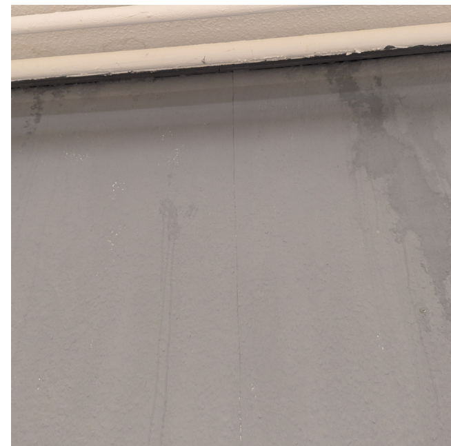
Wasserschaden im Kombiraum
