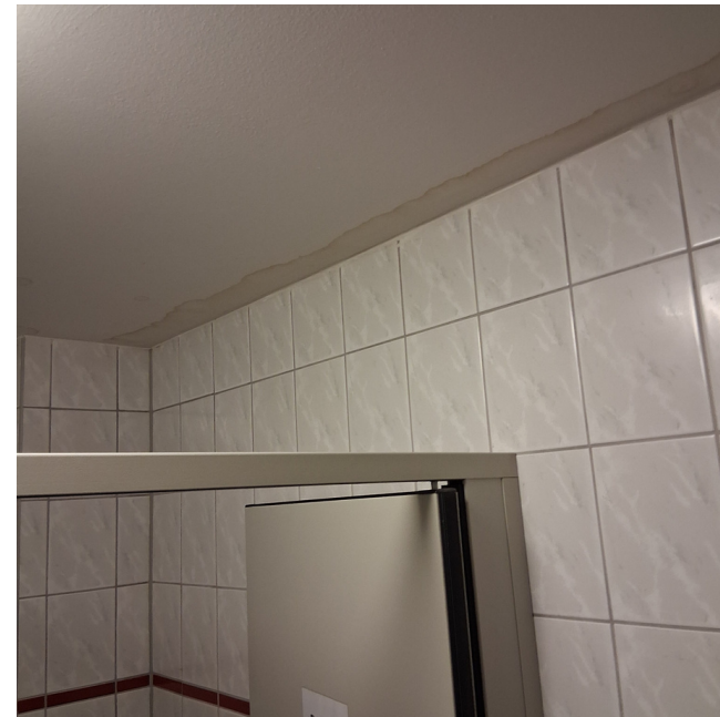
Wasserschaden in Sanitäranlagen
