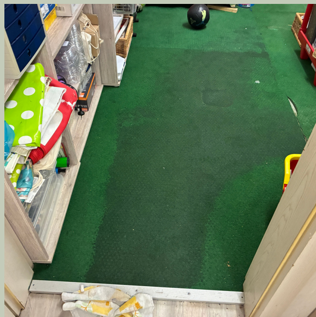
Wasserschaden im Lagerraum
