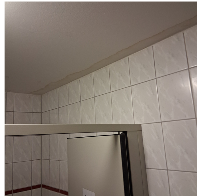
Wasserschaden in Sanitäranlagen
