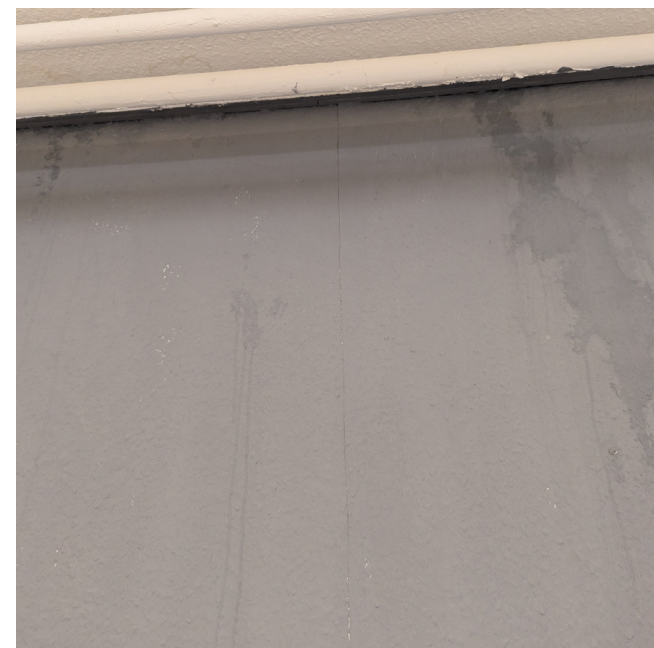
Wasserschaden im Kombiraum
