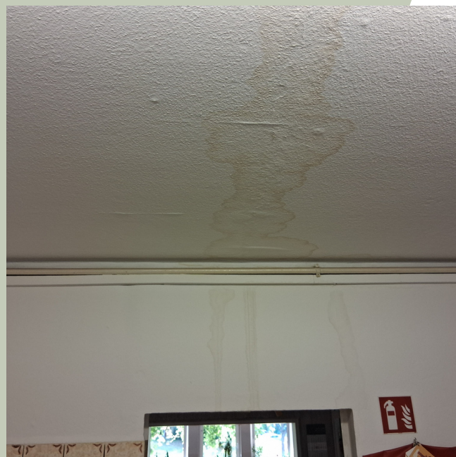
Wasserschaden in der Küche
