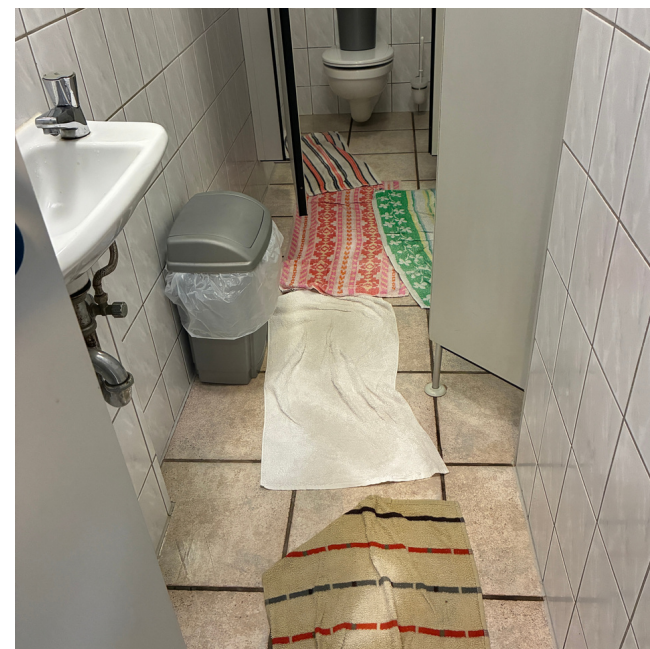
Wasserschaden in Sanitäranlagen
