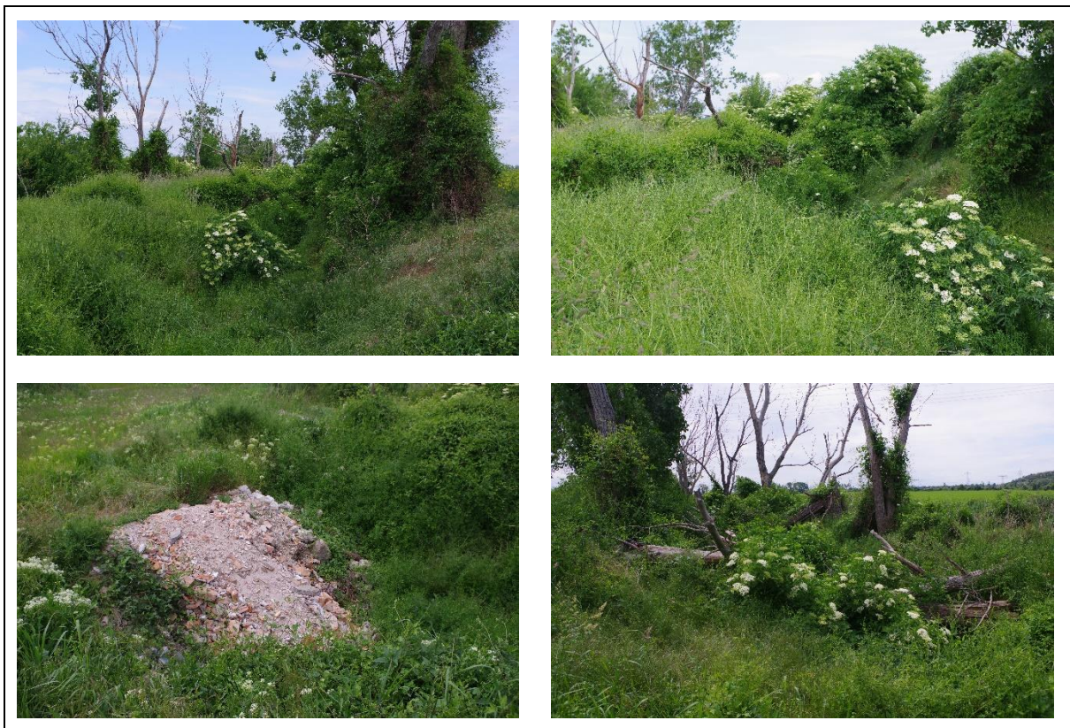
Abbildung 4.3: Behinderung der Wasserdurchlässigkeit des Beunaer Grabens durch starken Bewuchs, Bauschuttablagerungen und Totholz
